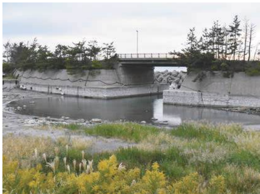
能登半島地震で海底が隆起し、水位が下がった港
